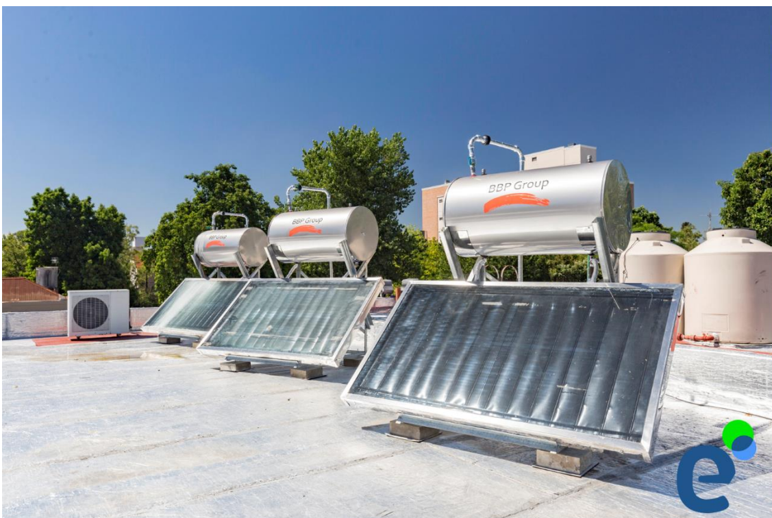
Termotanques de 180 litros en el edificio de Moreno
