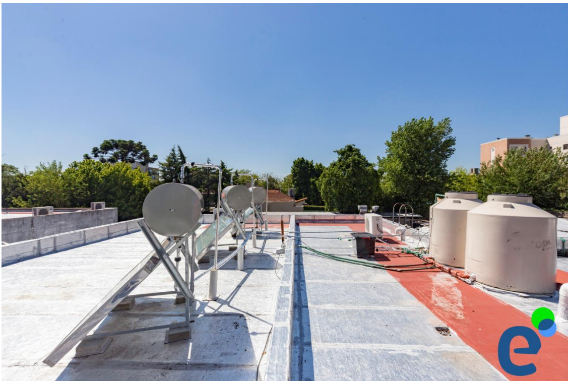
Termotanques de 180 litros conectados a los captadores solares
