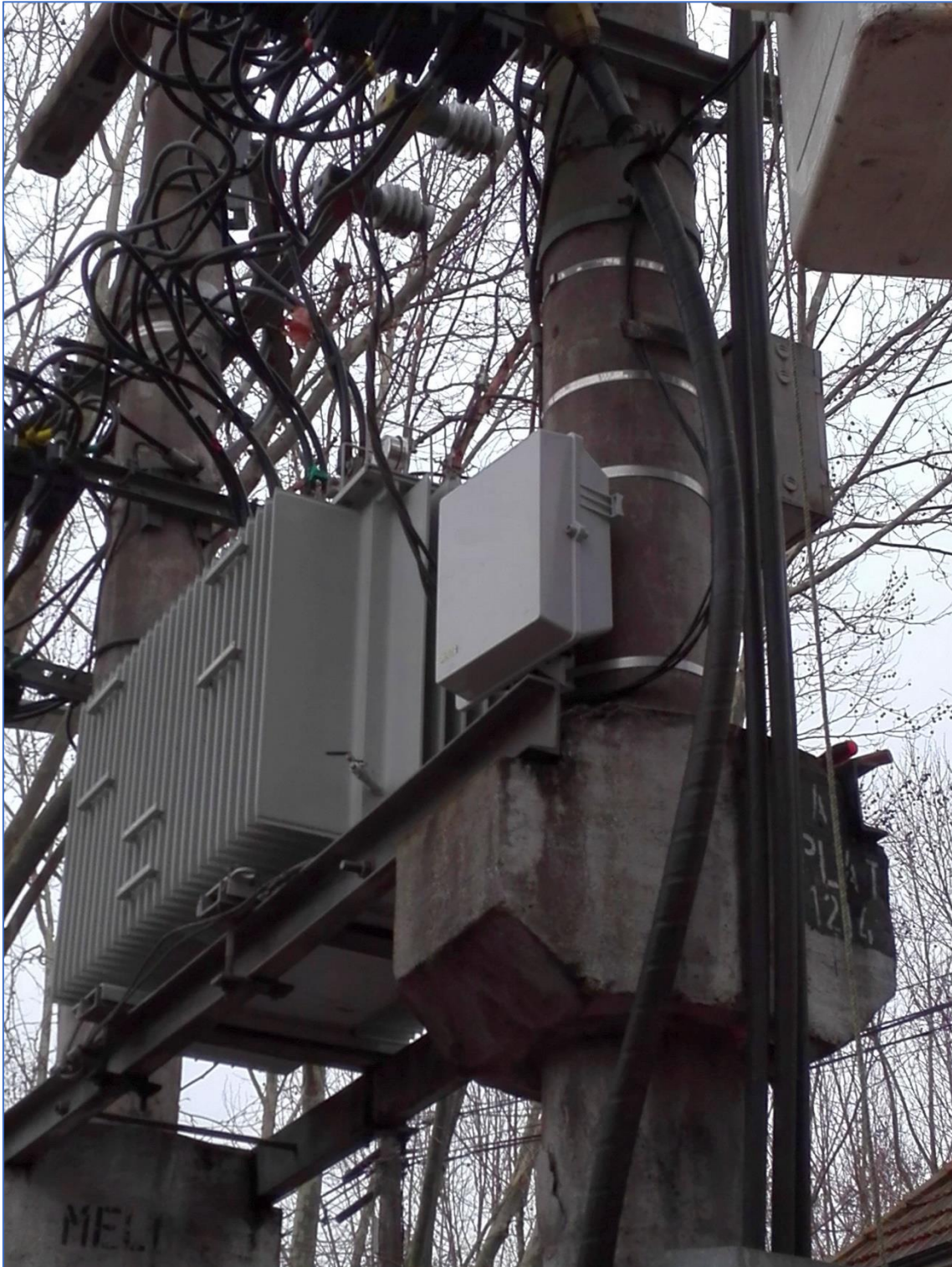
Concentrador de datos instalado en la red de baja tensión.
