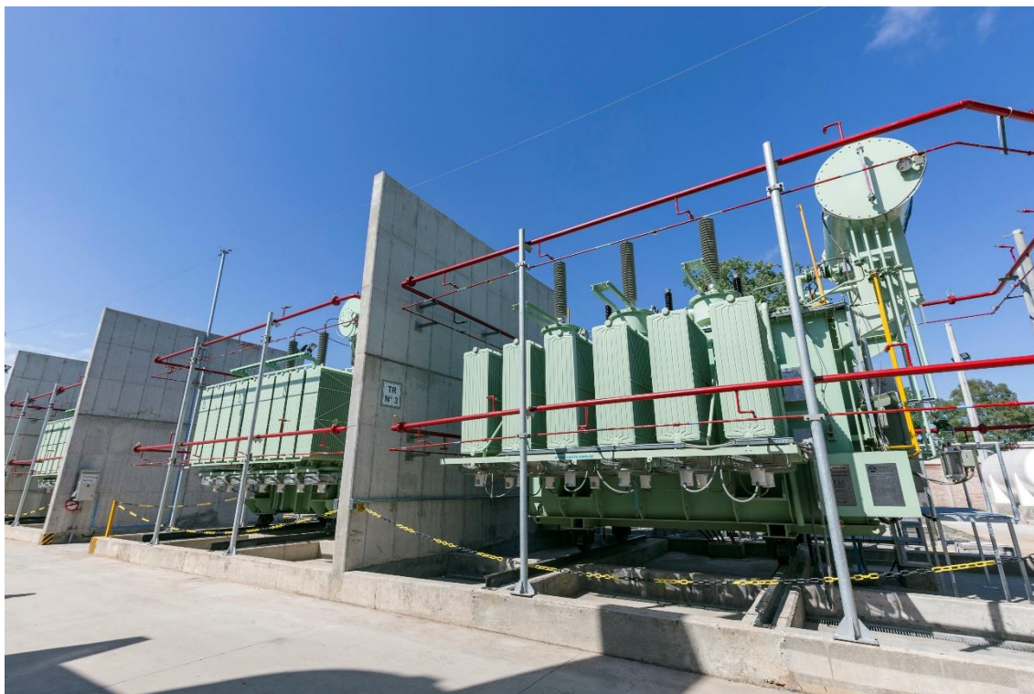
Playa de transformadores de Edenor, en la hoy inaugurada SSEE Gaona de Gral. Rodríguez.
