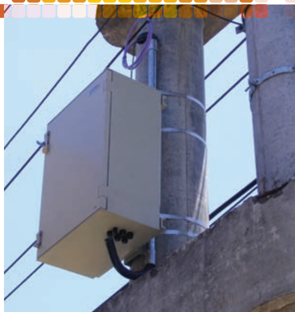
Unidad de telesupervisión en red aérea.
