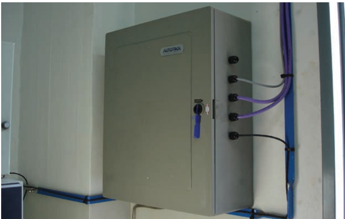
Unidad de telesupervisión en cámara.
