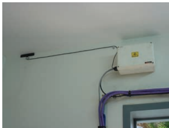
Módem GPRS en cámara.
