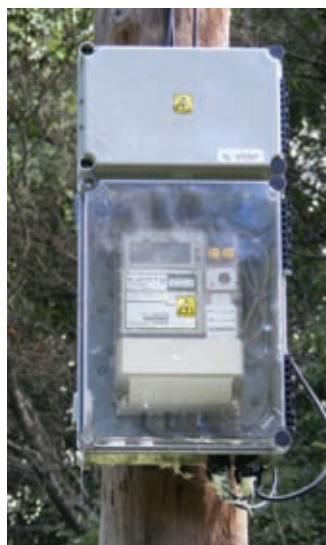
Recolector de interrupciones con gabinete estanco para módem GPRS.
