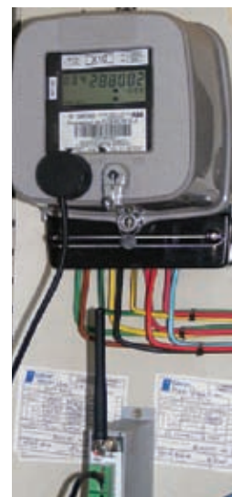
Medidor T3 con módem GPRS dentro del gabinete de medición.
