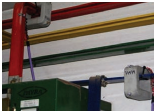
Recolector de interrupciones, con gabinete estanco para módem GPRS
